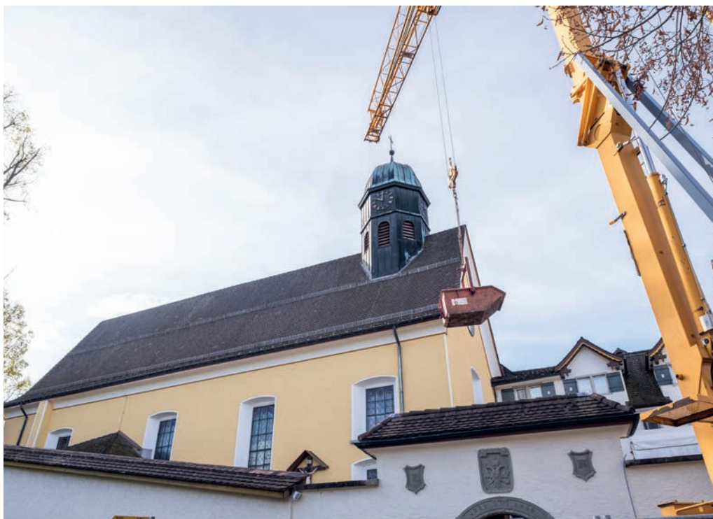
Während der ersten Monate lag der Fokus hauptsächlich auf dem Rohbau. Heizung, Lüftung und Elektronik der historischen Klosterkirche wurden erneuert. Fotos: tiz
